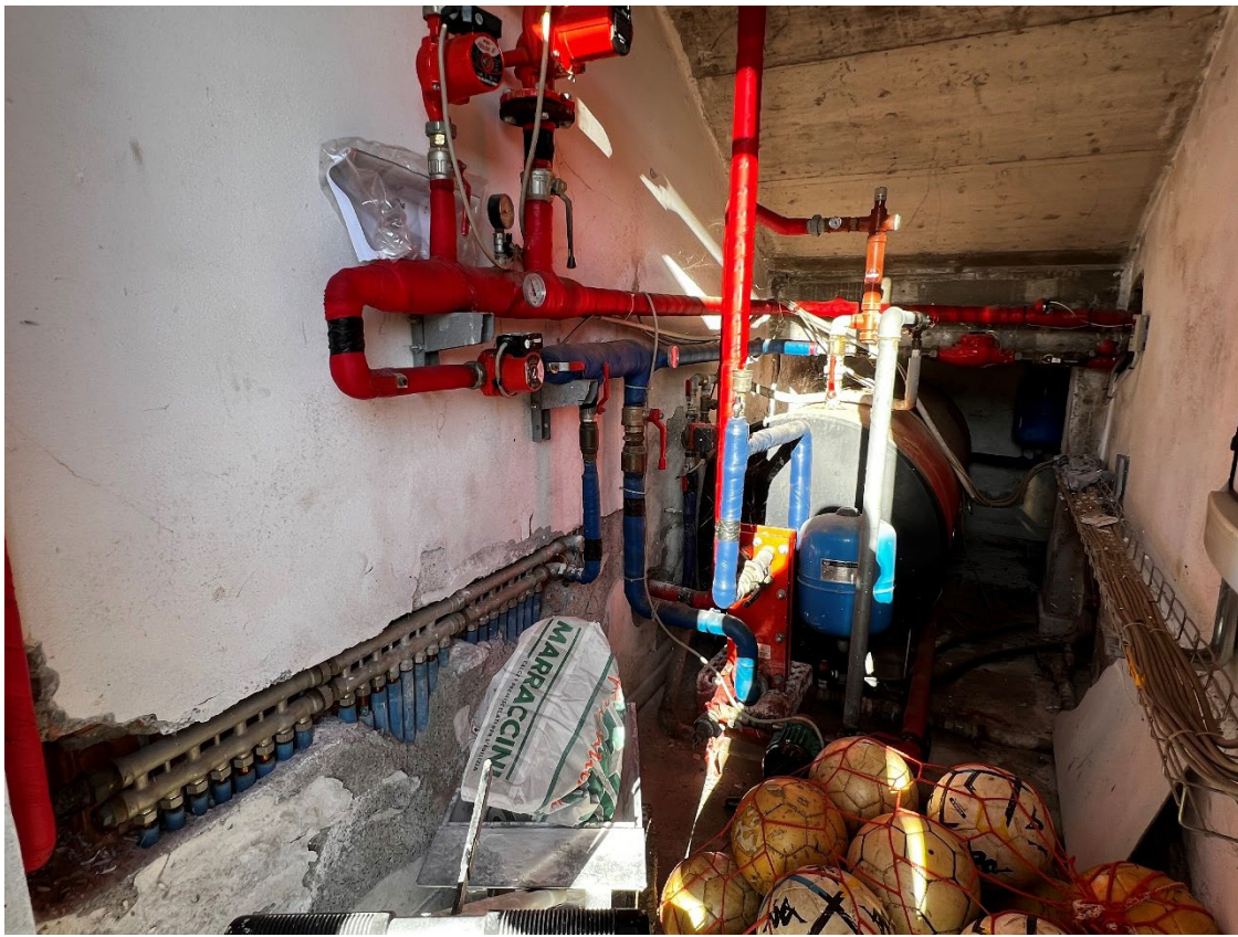
Locale pompe ed accumulo
