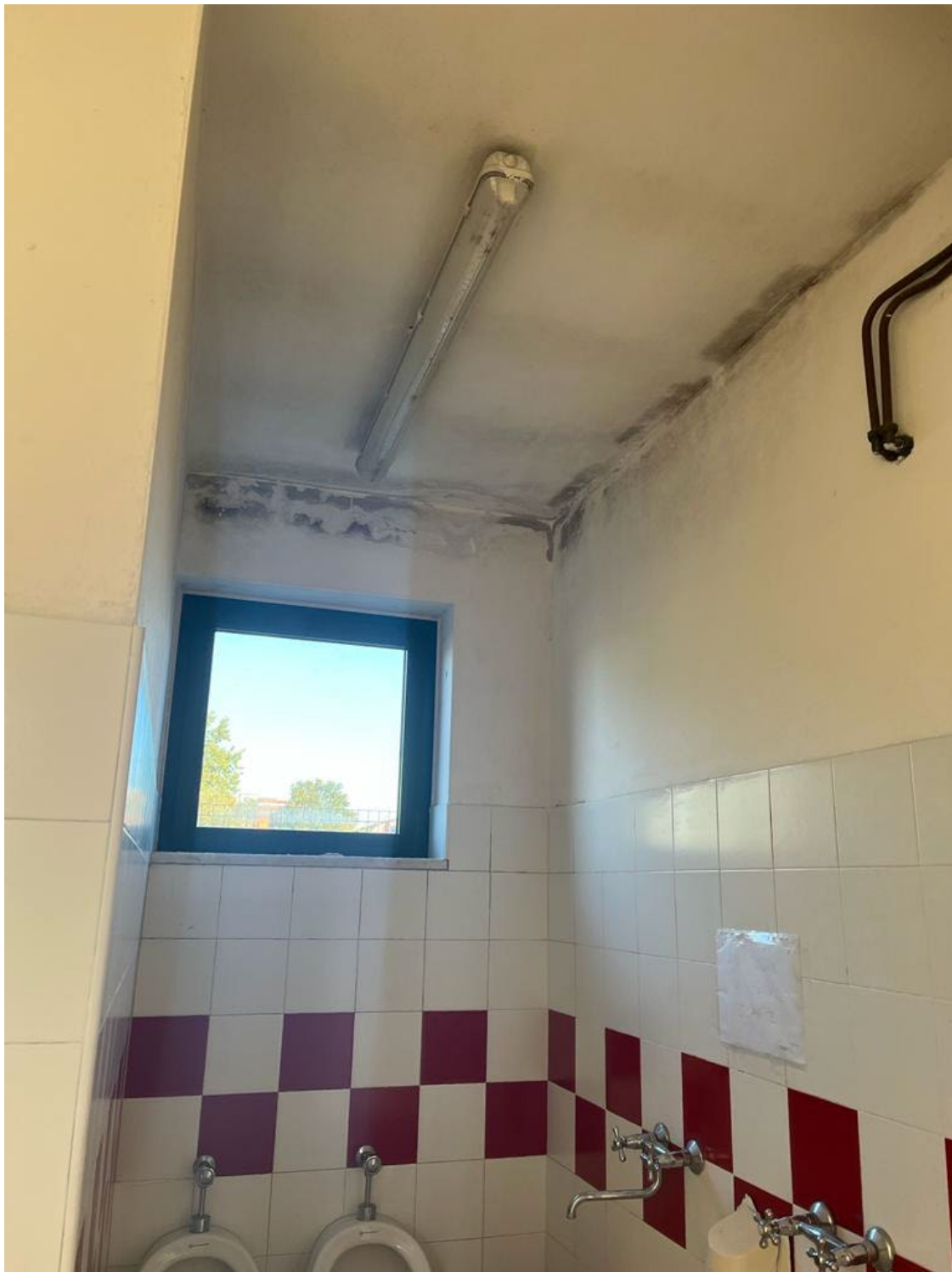
Evidenti infiltrazioni diffuse nei locali interni
